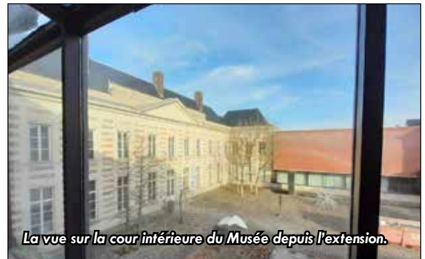
Visite du chantier le 22 novembre dernier, en présence de Martine Arlabosse, vice-présidente du Département du Nord en charge de la Culture.
